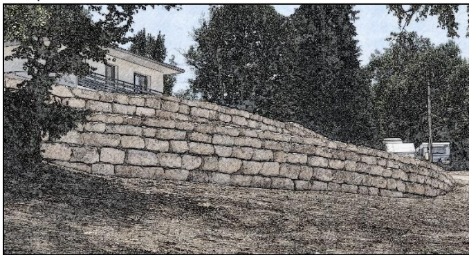
Exemples de soutènements non autorisés
