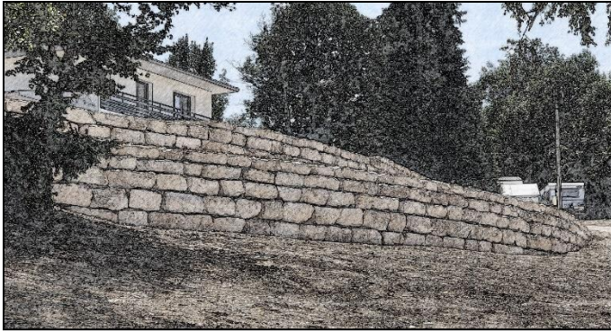
Exemples de soutènements non autorisés
