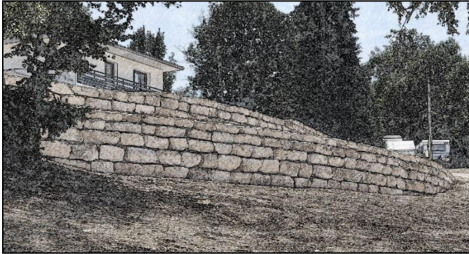
Exemples de soutènements non autorisés
