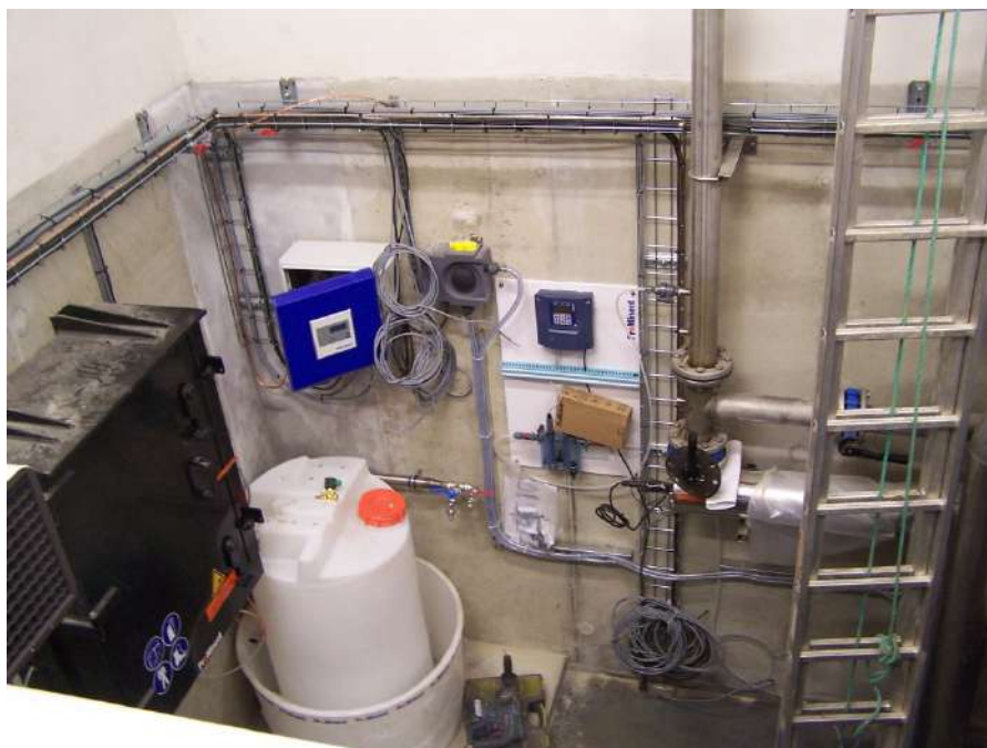
Photo n° 3 : Aperçu d'un traitement par électro-chloration
