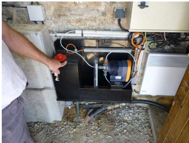
Photo n° 2 : Aperçu d'un traitement de javellisation
