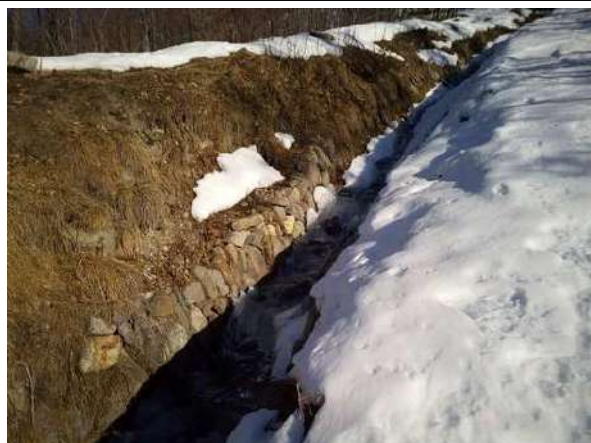
▲ Ruisseau des Choseaux: point sensible à l'érosion immédiatement en amont de la piste (cote 1540)
