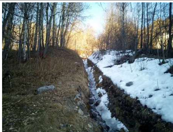
▲ Dégradation ponctuelle du perré rive droite, quelques mètres en amont du coude de la zone bâtie
