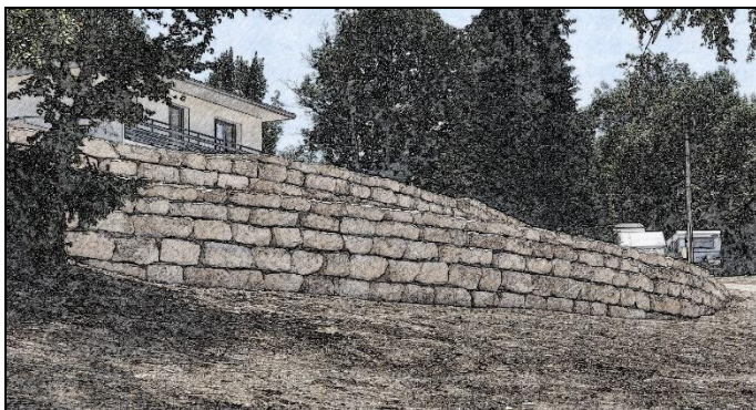
Exemples de soutènements non autorisés
