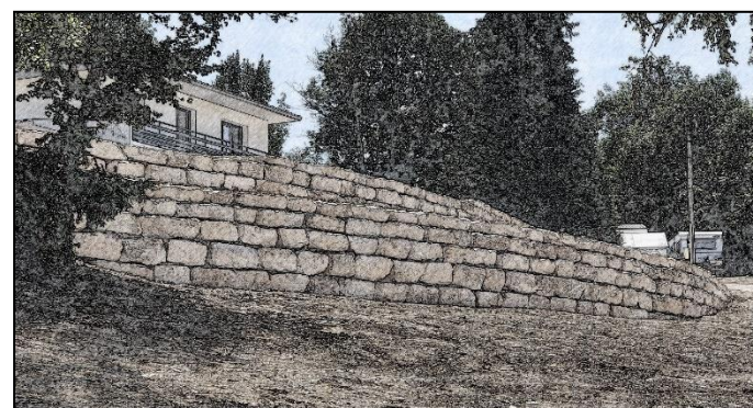
Exemples de soutènements non autorisés
