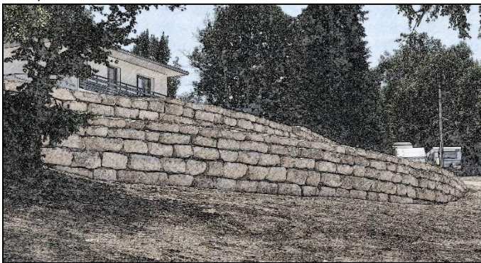
Exemples de soutènements non autorisés
