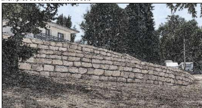
Exemples de soutènements non autorisés
