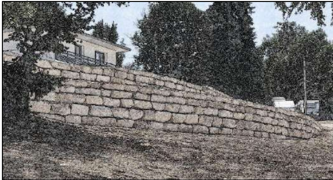
Exemples de soutènements non autorisés
