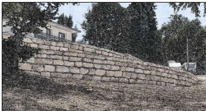
Exemples de soutènements non autorisés
